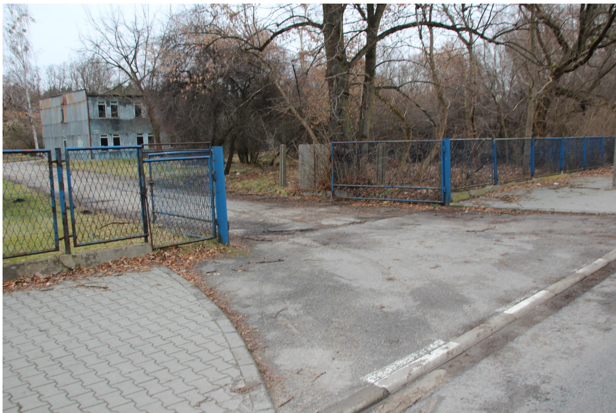
Zdj nr. 9 Brama wjazdowa do wymiany.
